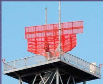
空港監視レーダー
